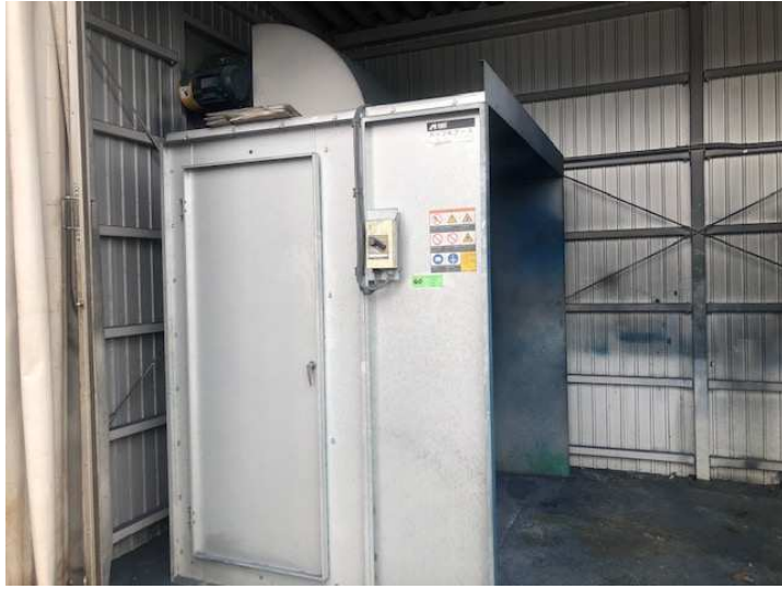
塗装ブース アネスト岩田製 環境への配慮した塗装作業
